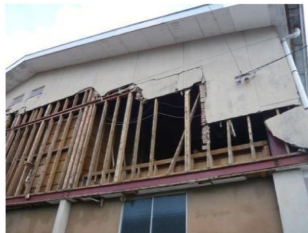
熊本地震 (H28.4.14) 屋内運動場の外壁の脱落
