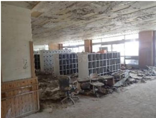
平成30年 7 月豪雨 校舎への床上浸水
