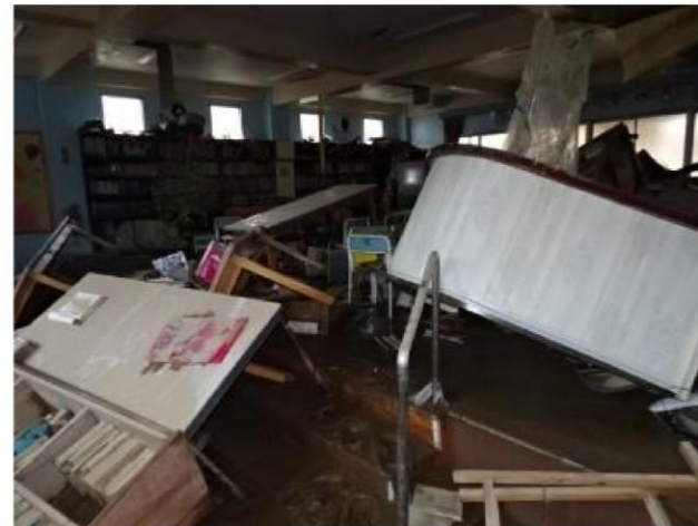
令和 2 年 7 月豪雨 図書室への床上浸水
