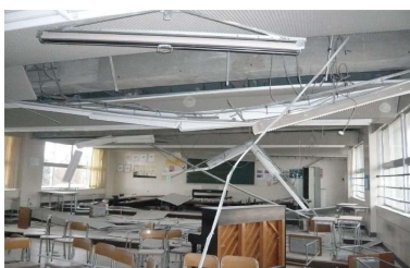
東日本大震災 (H23.3.11) 校舎の照明器具の落下
