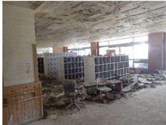
平成30年7月豪雨 校舎への床上浸水
