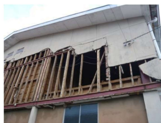
熊本地震 (H28.4.14) 屋内運動場の外壁の脱落
