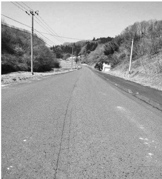
全く消えてしまっている区画線、早期設置が望まれる
