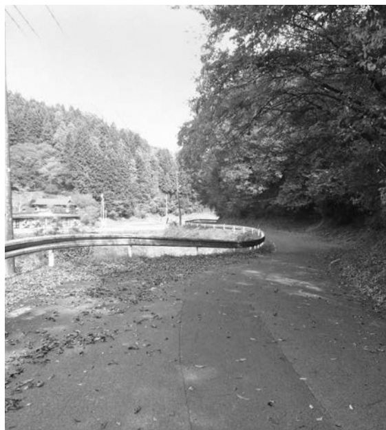
早期の改良整備が望まれる国道349号
