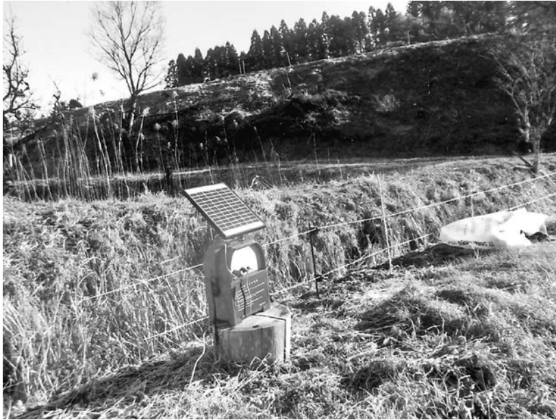
イノシシの進入防止の電気柵
