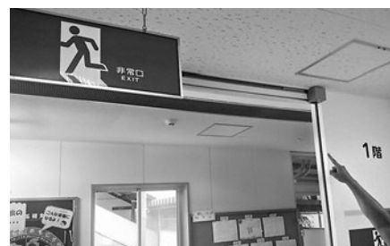
鮫川小の防火シャッター
