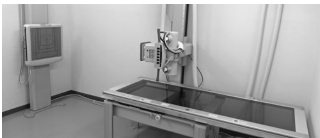
村診療所に新しく設置されたレントゲン撮影装置
