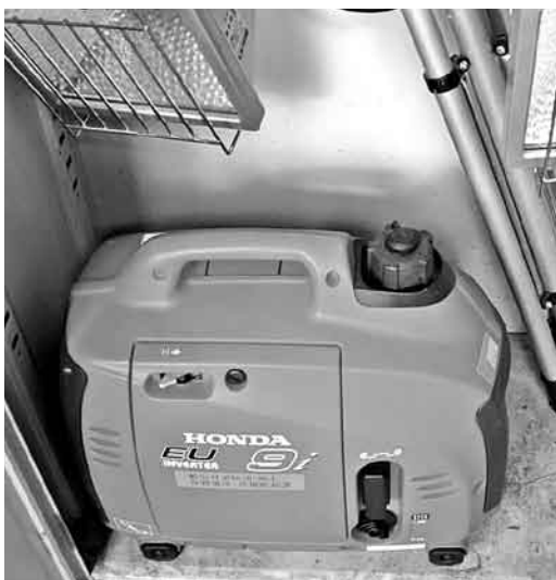
災害発生時のために準備されている非常用発電機
