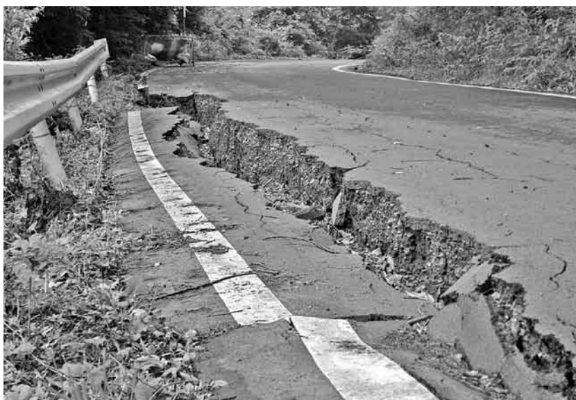
地震の被害により亀裂が入った村道戸草井出線
