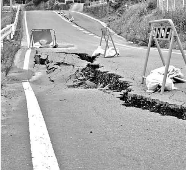
一日も早い復旧が望まれる林道の亀裂発生箇所
