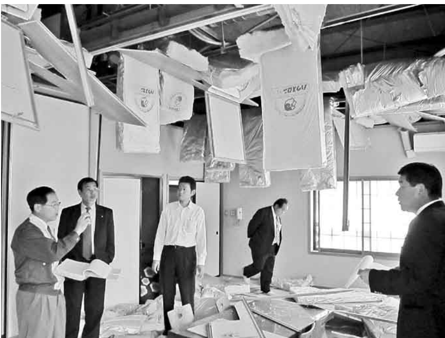
大地震の揺れにより天井が落下し被災した2階和室。 交流施設「ほっとはうす・さめがわ」
