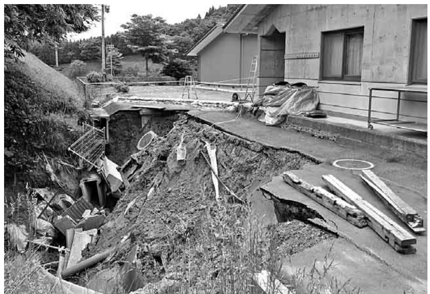
敷地の法面が崩落。高齢者総合福祉センター「ひだまり荘」
