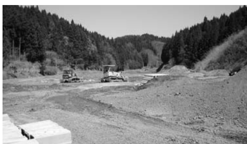
「鮫川村バイオマスүйレツジ構想」 堆肥センター建設地
