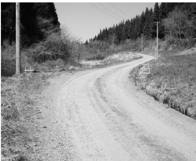
着工した林道前沼八斗蒔線舗装工事 22年度線越事業(富田字前沼地内)
