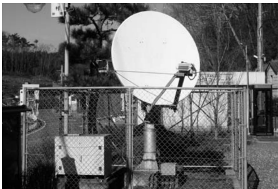
警報システムの受信アンテナ (衛星パラボラアンテナ)
