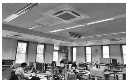
改修工事が終了した庁舎空調設備
