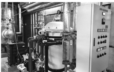
温泉の衛生管理に重要な濾過装置
