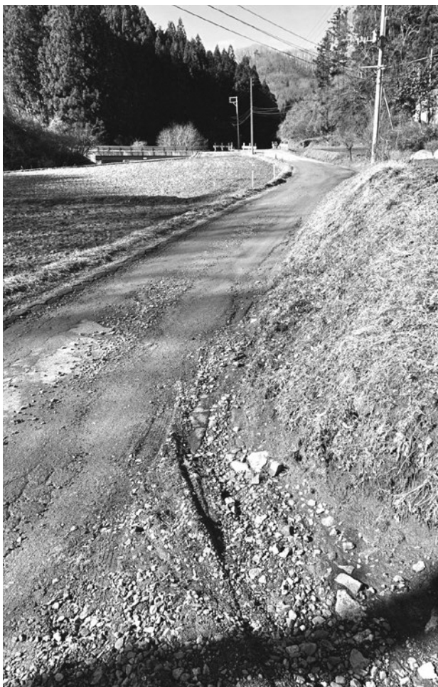
内ヶ竜地内の未改良区間の土砂流出時のようす
