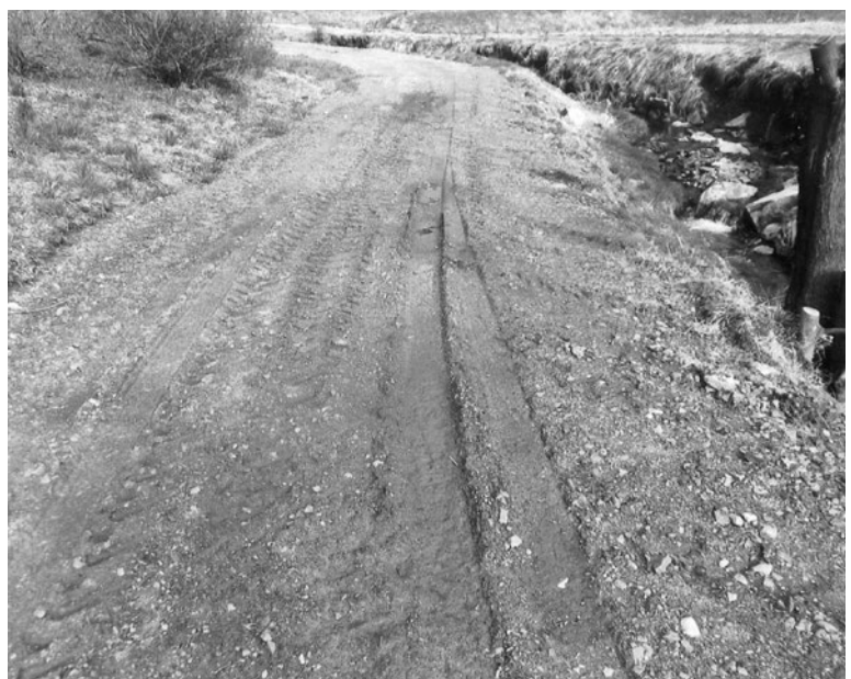
路肩崩壊や寸断の被害が発生した住宅進入路
