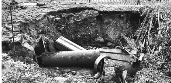
早期復旧が望まれる台風19号被災箇所
