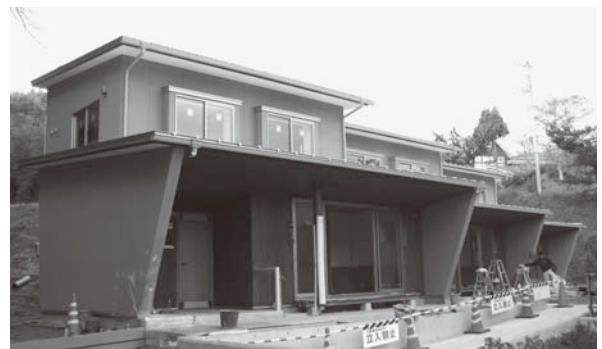
定住人口の増加が期待される公営住宅 (水口地内工事現場)
